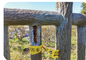
柵の損傷の様子
